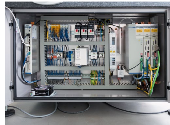
Quadro elettrico della LSW 330.
